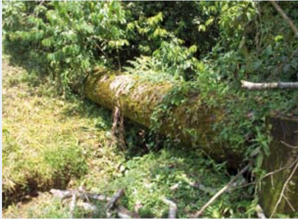
Estado de deterioro de la conducción principal de agua captada.
