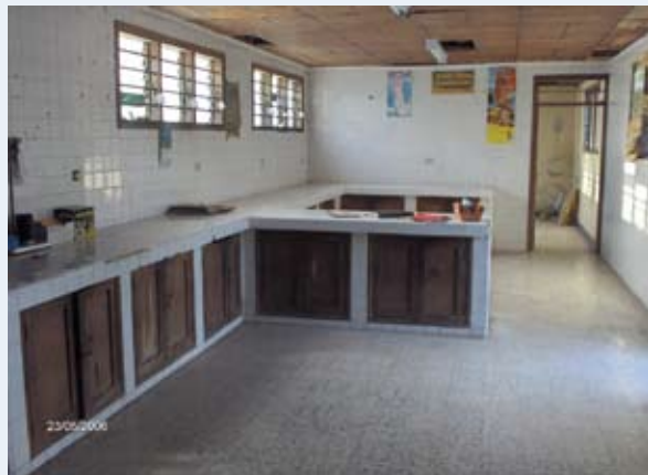
Laboratorio de la planta de tratamiento que no esta en uso, La ESP no realiza pruebas de potabilidad al agua, sin embargo en sus costos esta un funcionario contratado tiempo completo para hacer control de calidad al agua.
