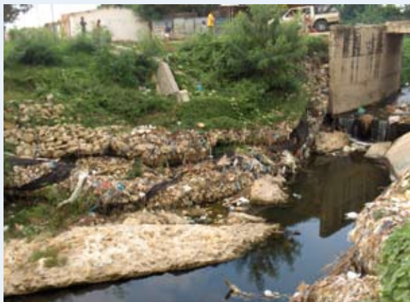
Contrato Estabilización de talud con gaviones Arroyo Santo Domingo, canastas de gaviones deformados.
