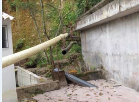
Tubería elevada sin soporte, inestable con posibilidad de ruptura.
