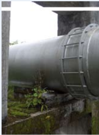
Tubería no se encuentra ajustada. Está soportada por pedazos de madera sin el anclaje requerido.
