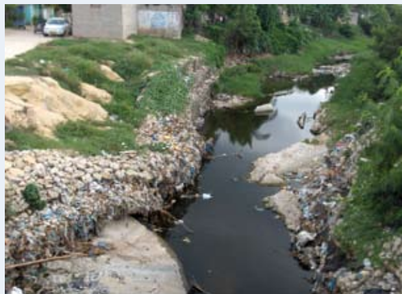
Contrato Estabilización de talud con gaviones del Arroyo Santo Domingo y muro lateral derecho colapsado.
