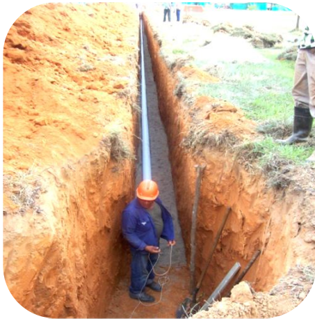
Foto: Liliana Cañas Baquero. Construcción del alcantarillado sanitario en el municipio de La Primavera, departamento del Vichada.
